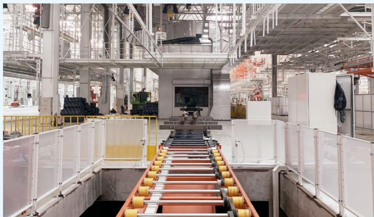
9月15日，中建安装东北公司参建的一汽解放汽车有限公司新建J7智能装配线项目进入试运行阶段。项目建成后将达到汽车工业与5G、工业互联网、大数据等新基建技术的融合；可满足质量可控、自动可用、生产可视、信息可通、智能可行等需求；可实现年产5万辆解放牌J7重商用商用车、一汽解放2025年整车销售50万辆的目标；有利于快速提升国产汽车品牌国际竞争力，为吉林省汽车产业腾飞助力。
